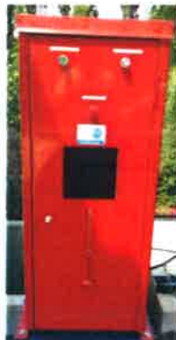
Photo 2 : coffret de commande manuelle avec bouton poussoir en façade et voyants
